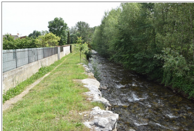
Figure 3.10: petit endiguement du lotissement de la Cité "Des 150".
